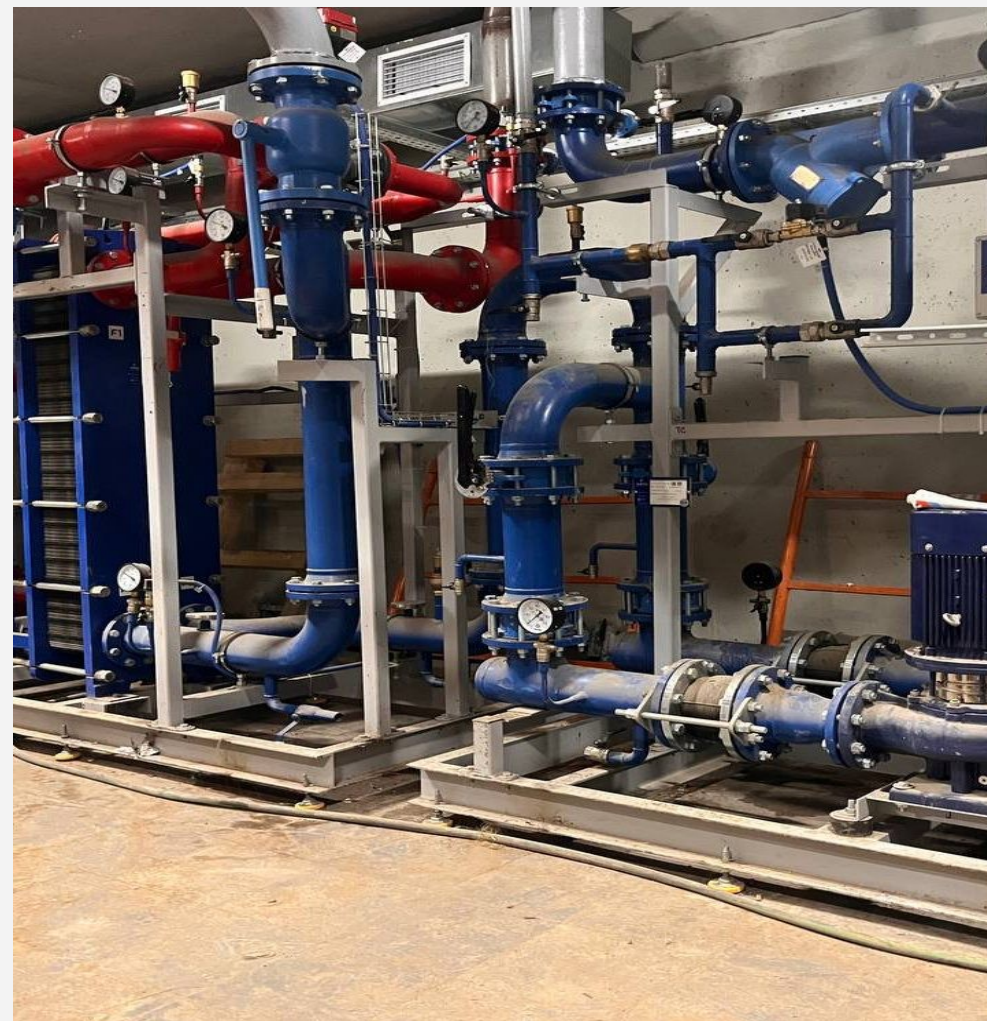
ИТП бизнес-центра на Полесском проезде, 2026
