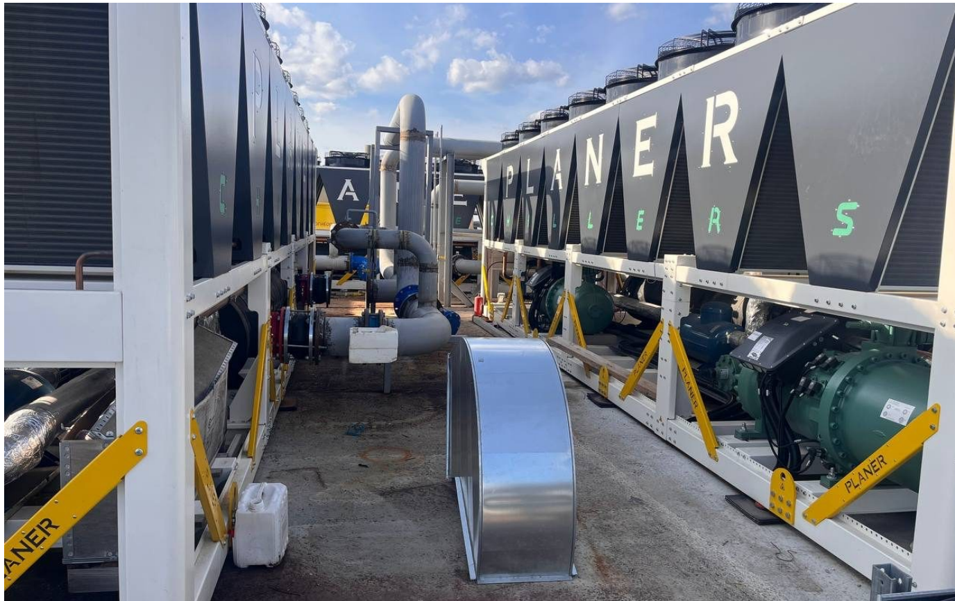
Чиллеры PLANER на кровле
